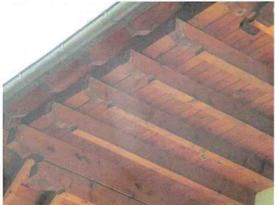
Abb. A2: Vogelkot auf den Dachbalken
